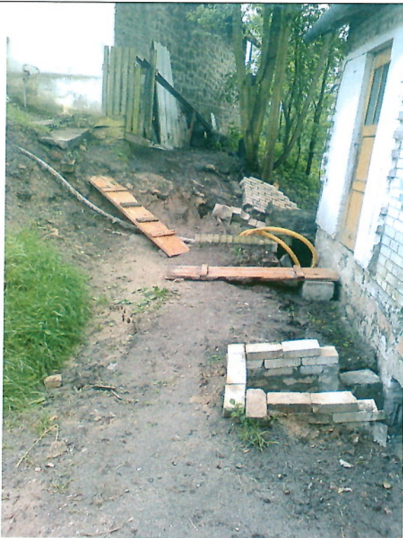
Fot. 7. Osunięty i przechylony budynek gospodarczy ; stan – maj 2010 (fot. pp. Pokora)
