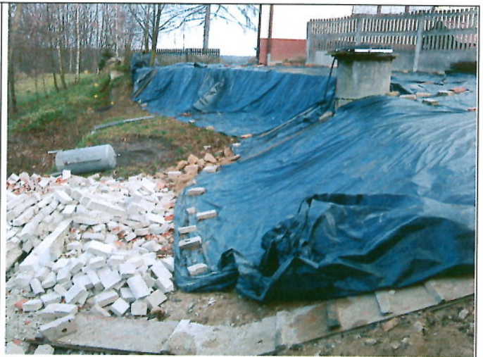
Fot. 4. Skarpa osuwiskowa (widok w kier. pn). – skarpa zasłonięta folia oraz studnia kopana zabezpieczona systemem gospodarskim (częściowo podsypana) – stan 10 listopada 2010 (fot. T. Mrozek)
