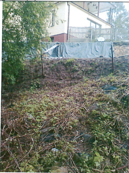
Fot. 1. Widok skarpy osuwiskowej – stan – maj 2010 (fot. pp. Pokora)
