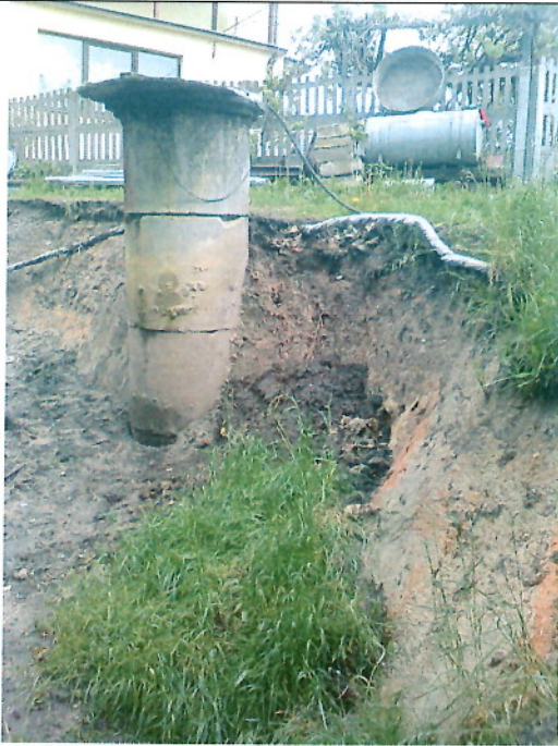
Fot. 3. Zarys skarpy osuwiskowej i odsłonięta studnia gospodarska – przesunięcie pionowe ok. 2 – stan maj 2010 (fot. pp. Pokora)
