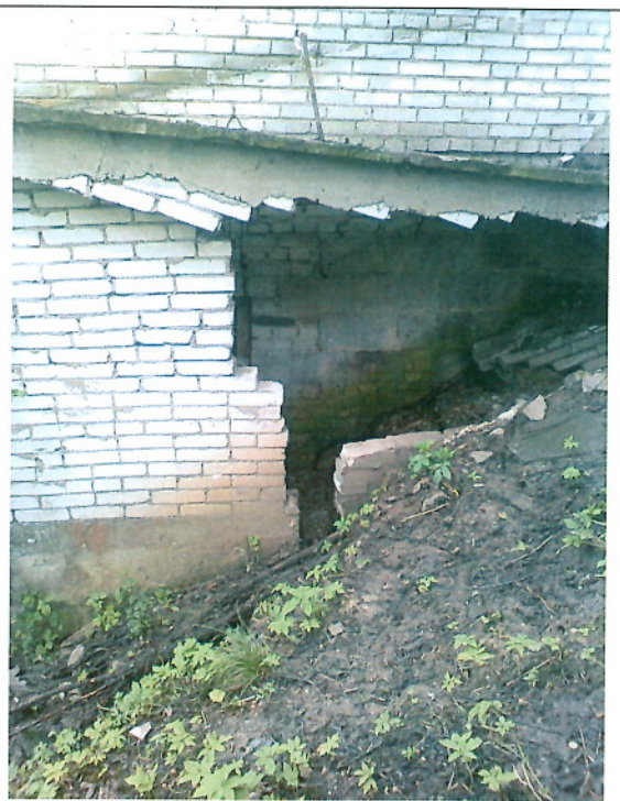
Fot. 8. Uszkodzenia budynku gospodarczego – maj 2010 (fot. pp. Pokora)
