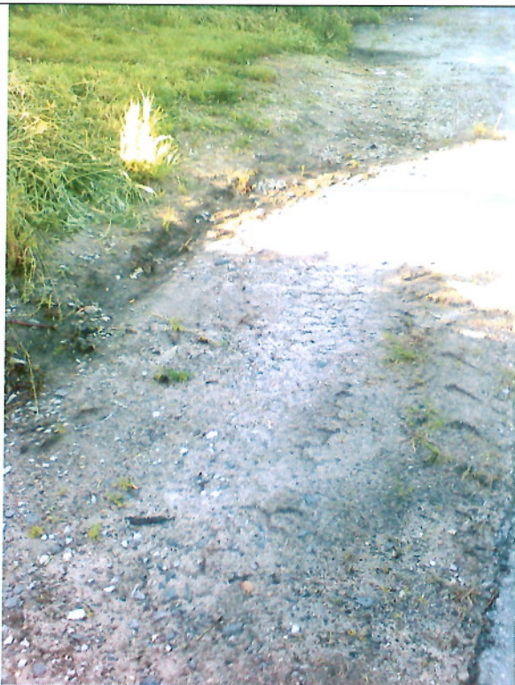
Fot. 9. Uszkodzenia drogi – maj 2010 (fot. pp. Pokora)
