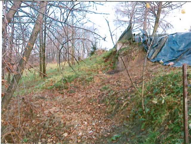
Fot. 5. Skarpa osuwiskowa – widok w kierunku pn. – stan 10 listopada 2010 (fot. T. Mrozek) -
